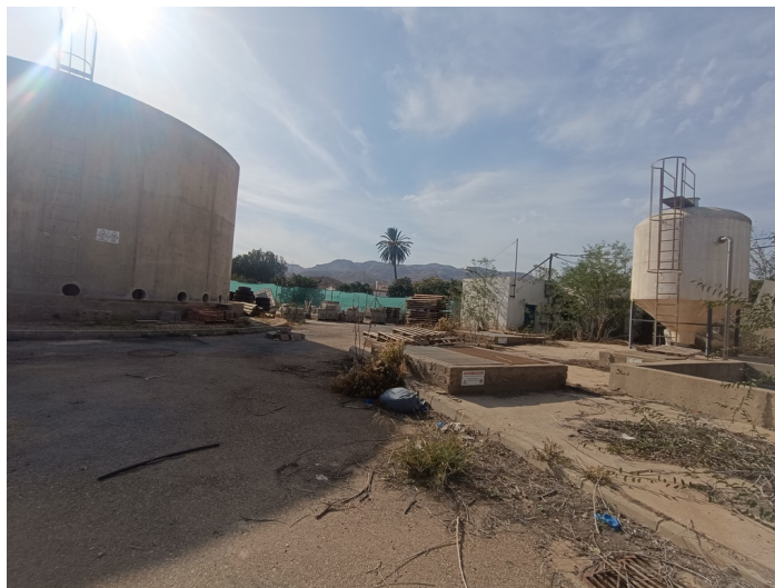
EDAR Estación Depuradora DS. CM Pechina
