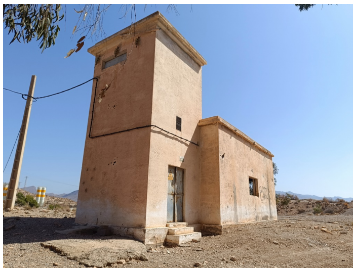
Transformador eléctrico DS La Viña
