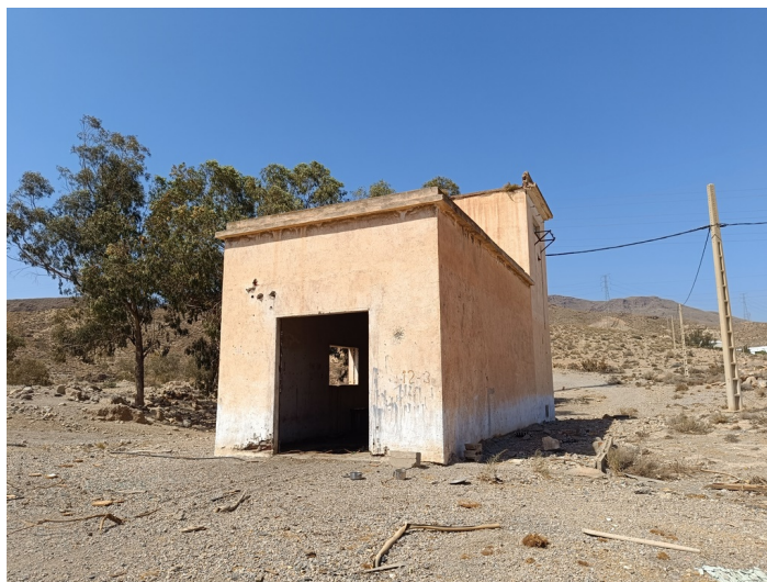
Transformador eléctrico DS La Viña
