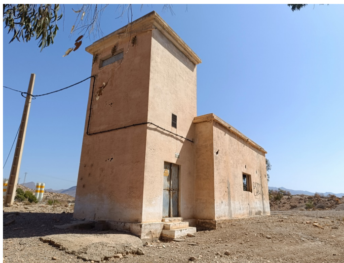
Terreno Transformador eléctrico DS La Viña
