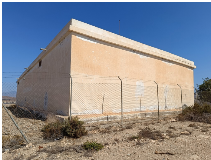
Depósito Nuevo para el Agua
